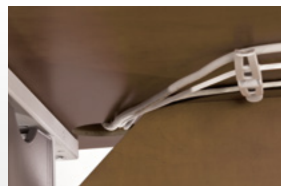
A rögzítőelemek biztosítják a kábelek praktikus vezetését a munkalap alatt
